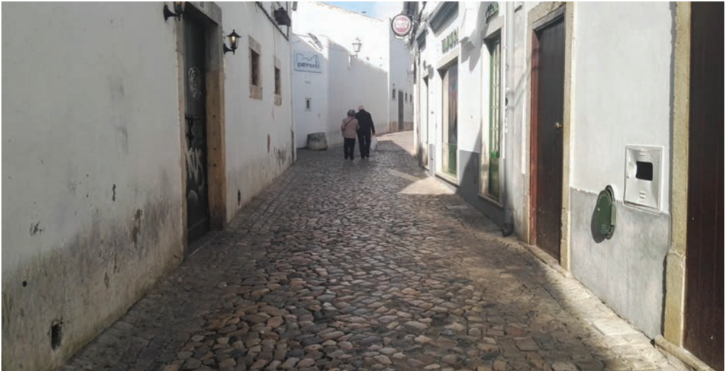
Foto 1. Pavimento irregular en zona peatonal
