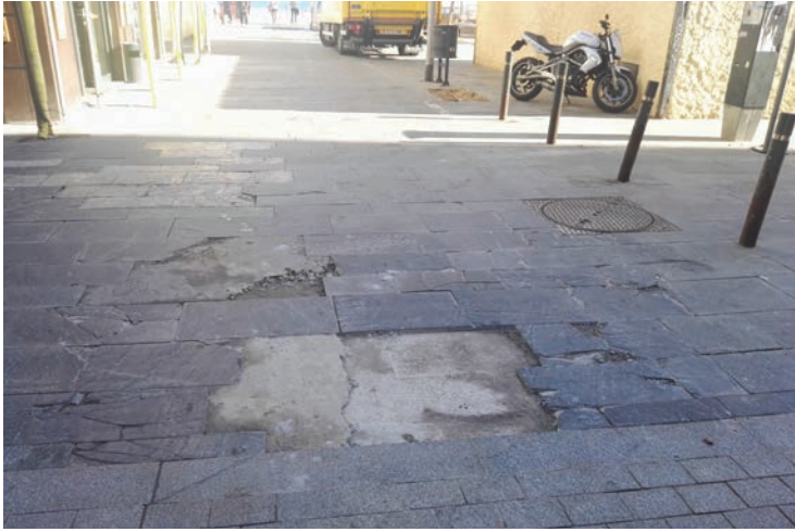
Foto 3. Rotura del pavimento debida al paso de vehículos pesados
