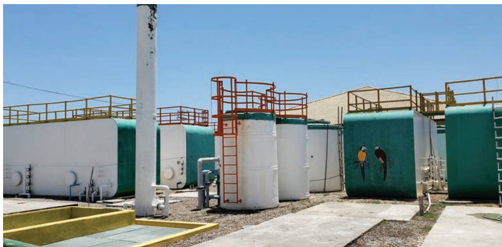
Foto 3. Sistema Revolution instalado no condomínio Golf Ville , em Fortaleza
