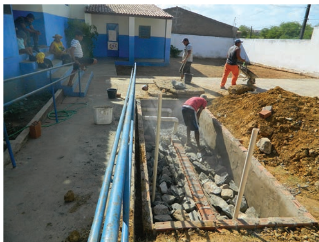
Foto 7. Sistema de tratamento de esgoto com câmara anaeróbica em cerâmica, na cidade de Batalha, Alagoas - Projeto Rondon, PUC-Rio
