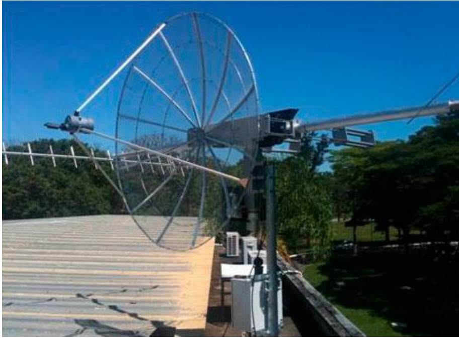
Figura 28 - Vista das antenas da estação terrena do ITA.
