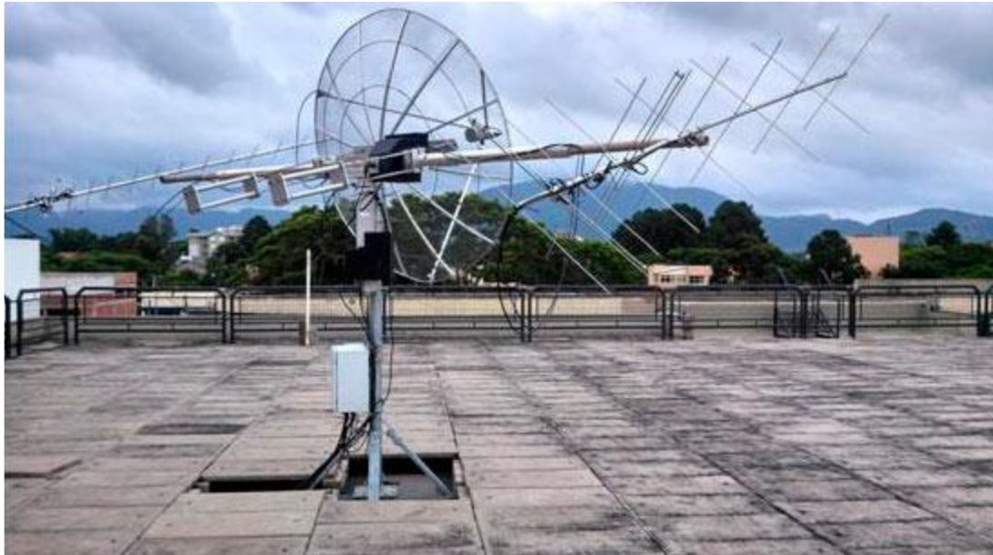
Figura 27 - Vista das antenas da estação terrena do INPE/Santa Maria. Fonte: http://www.inpe.br/sul/nanosat/estacoes/estacao_santa_maria.php .
