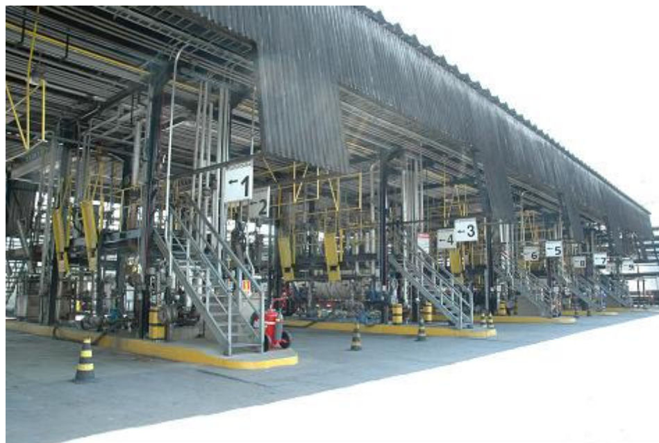
Figura 5.3-30: Ponto de transferência de combustível dos caminhões para os tanques
