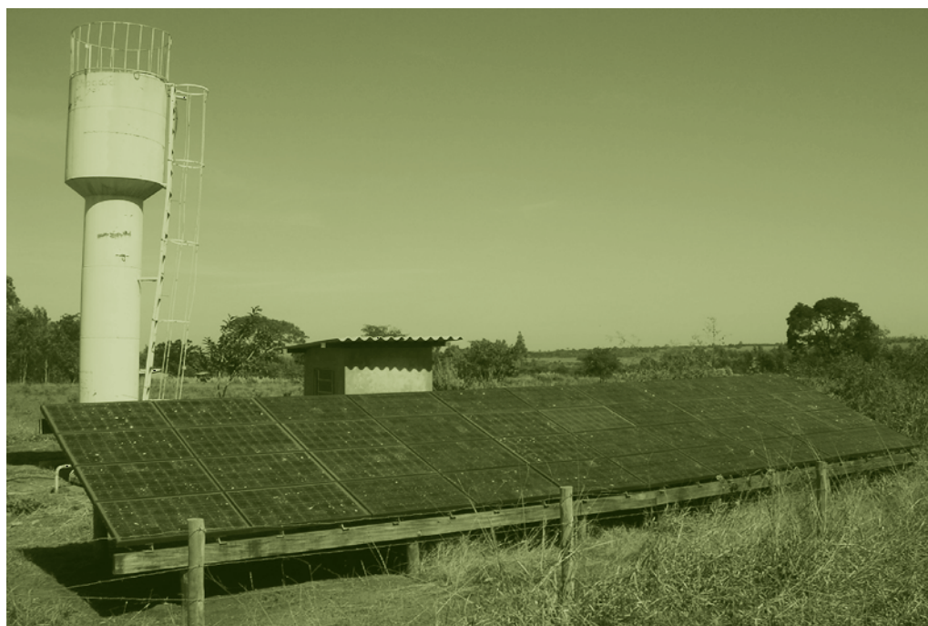
Figura 3: Sistema FV de Bombeamento instalado em assentamento agr  cola no Munic  pio de Presidente Bernardes (SP). Motobomba nacional e unidade de condicionamento de pot  ncia WEG-Automa  o.
