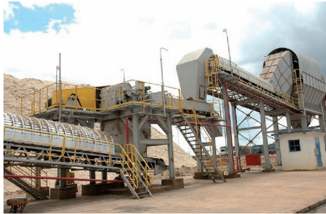
Figura 12: Estação de limpeza a seco instalada na Usina Equipav, SP
