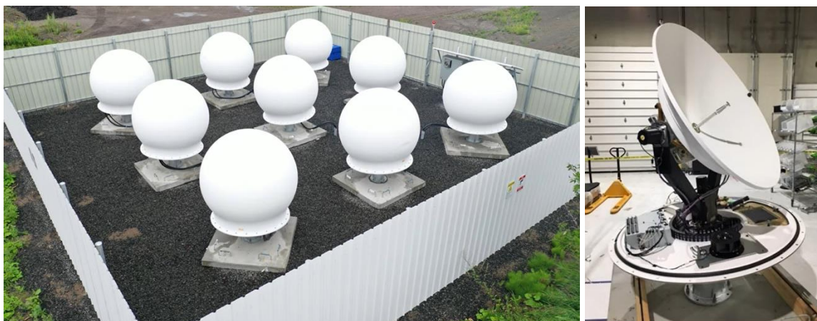
Figura 4.10 – Antenas parabólicas das estações de solo com cobertura (esq.) e descoberta (dir.).
