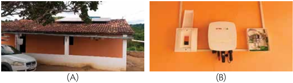
Foto 2. Instalação de sistema fotovoltaico em empreendimento da agricultura familiar
